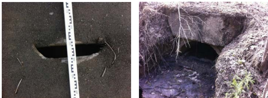
Рис. 3.12. Дефекты водопропускных сооружений
