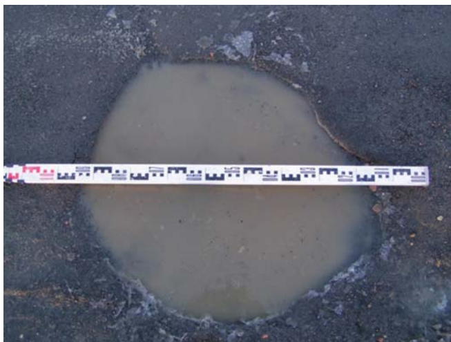
Рис. 3.14. Выбоина на покрытии лесной дороги
