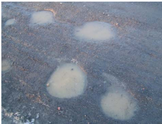
Рис. 3.16. Пример неудовлетворительного содержания дороги
