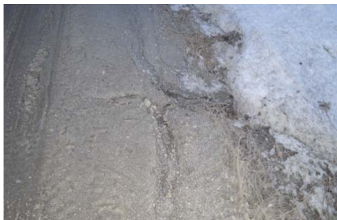
Рис. 3.10. Размыв бровки земляного полотна талыми водами
